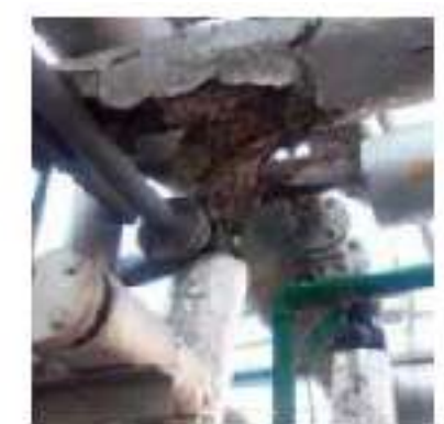
Aislante térmico de tuberías
