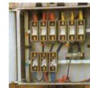
Panel eléctrico con cinta aislante de asbesto
