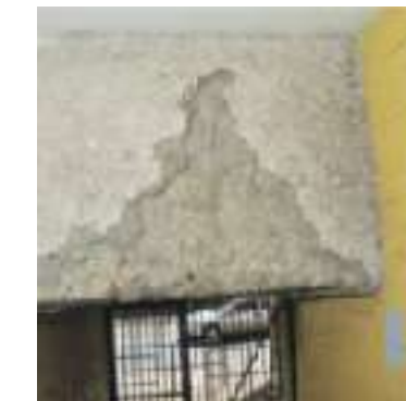
Aislante de asbesto proyectado
