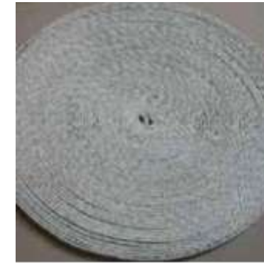
Cinta y cuerda con asbesto
