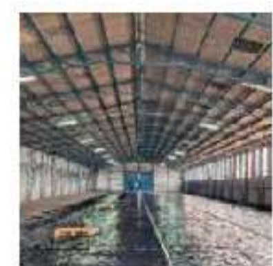
Techumbre de asbesto galpones industriales
